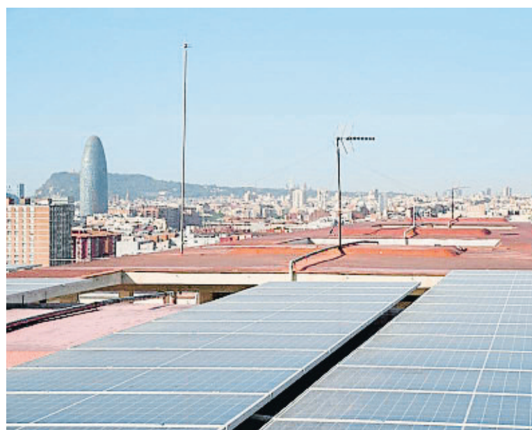
Una instalación en la azotea de un edificio en Sant Martí
