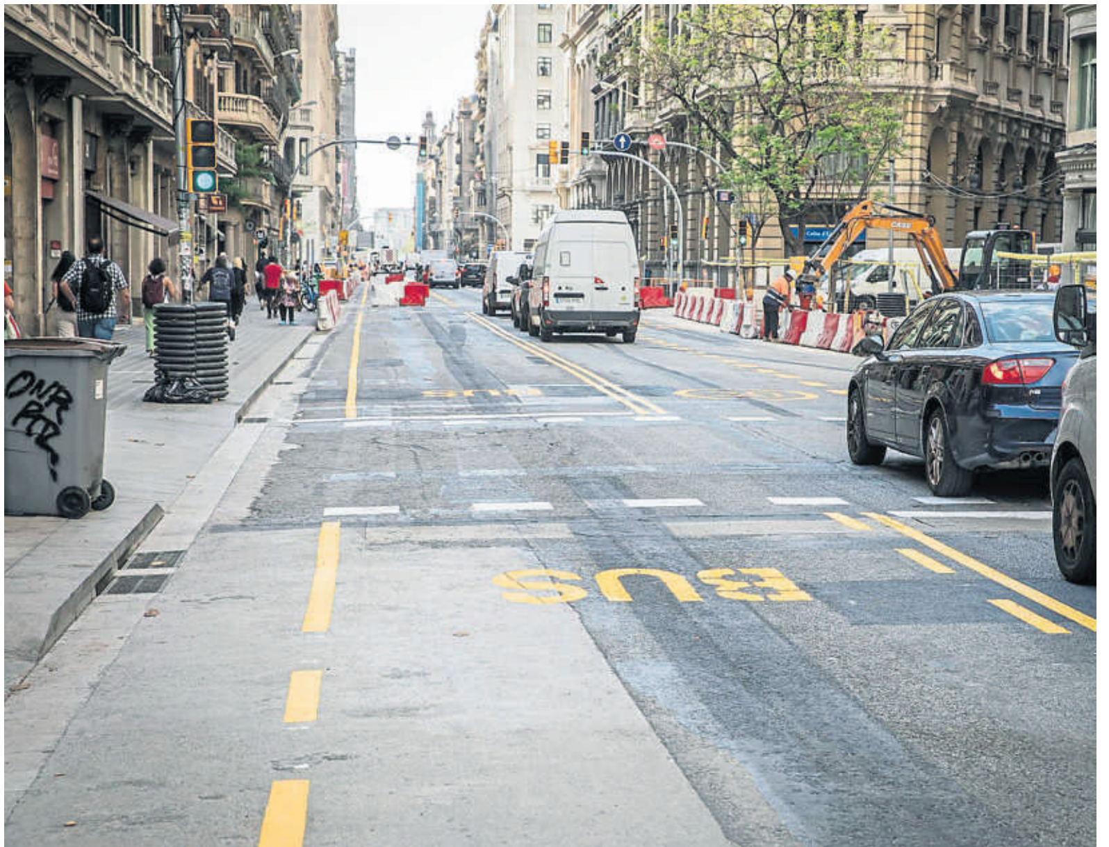
Las entidades coinciden en reclamar más consenso al abordar transformaciones urbanas; en la imagen, la Via Laietana en obras
